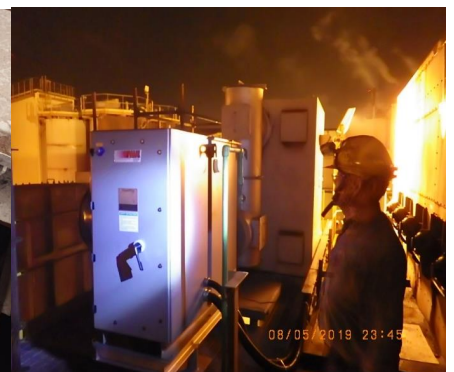
F 鋼鐵: 高頻變壓器
