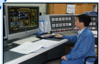
控制室監控系統
